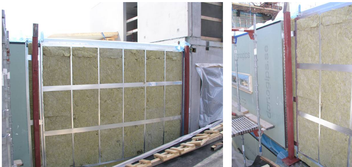
Obrázek 2.2 Prefabrikované prvky v kombinaci s nosnou ocelovou konstrukcí v úspěšných systémech pro obytné konstrukce ve Švédsku
