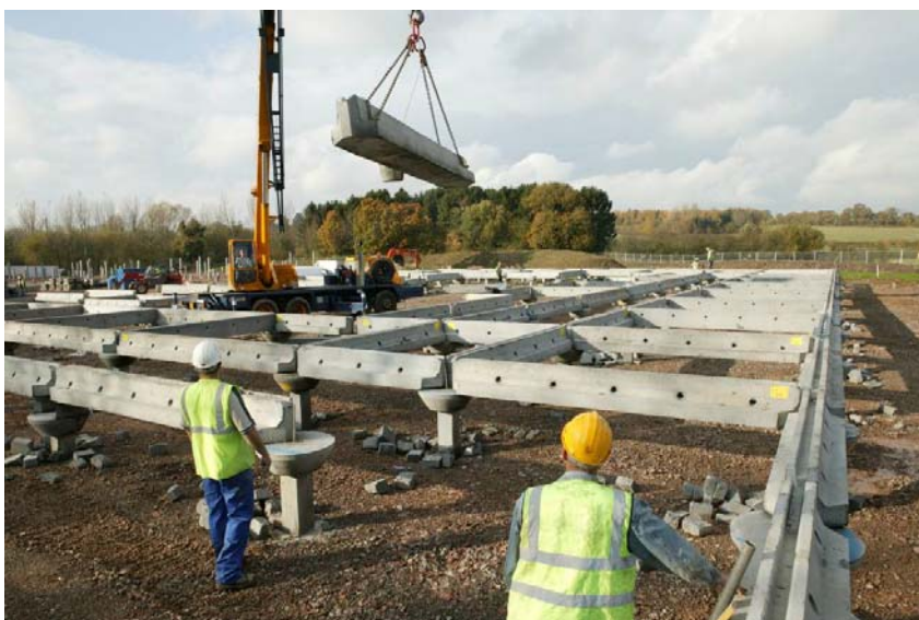
Obrázek 2.3 Prefabrikované betonové nosníky na terénu a piloty, které podpírají lehkou ocelovou konstrukci
