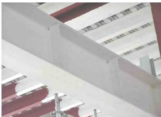
Obrázek 5.2 Zpěňující nátěr na nosníku suterénu
