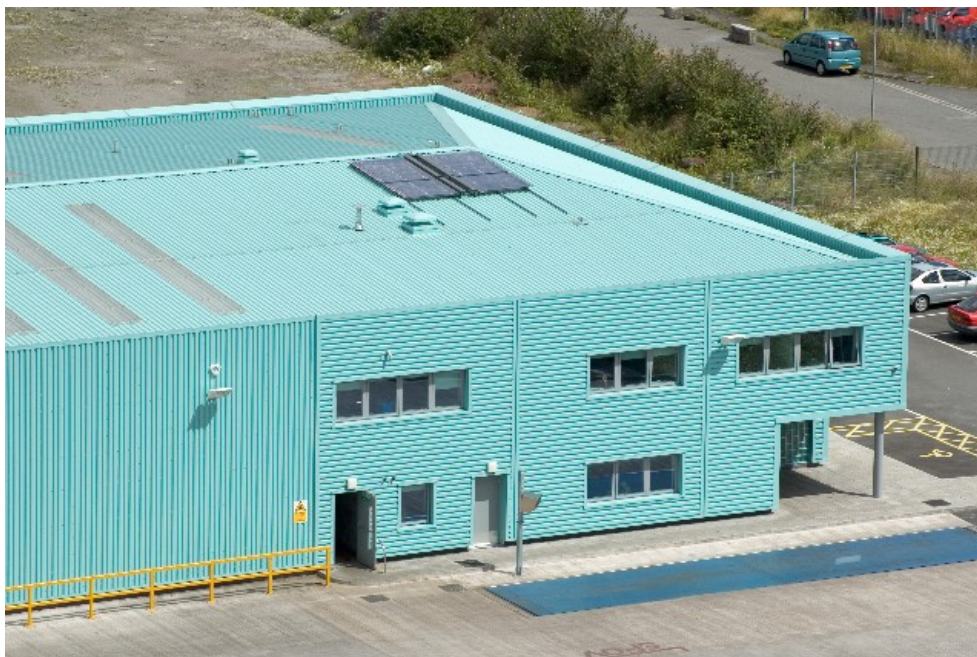
Obrázek 2.10 Skládaný střešní systém s atikami a vnitřními kanalizačními svody (Fotografie s laskavým svolením Corus Colors)
