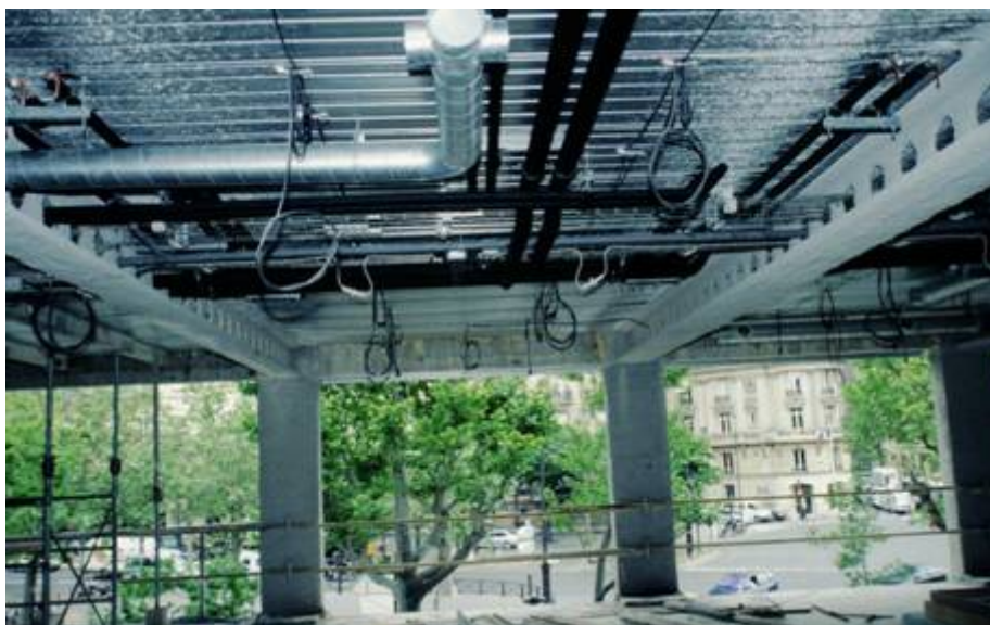
Obrázek 6.10 Nosníky s kruhovými otvory a s rozvody technického zařízení prostupujícími otvory ve stěnách nosníků [15]
