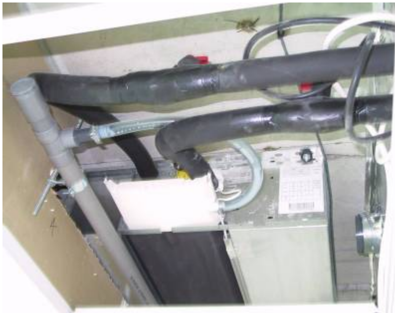
Obrázek 3.1 Klimatizační jednotka s ventilátory s vlastním obslužným potrubím
