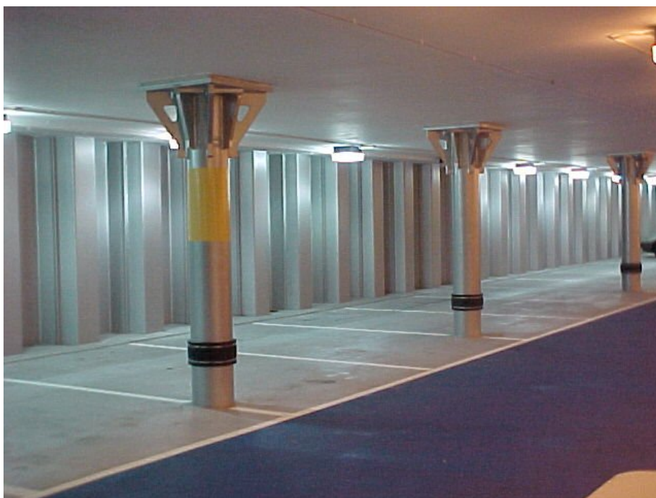
Obrázek 6.1 Štětová stěna a sloupy ve výstavbě systémem „shora dolů“, použité pro podzemní parkoviště
