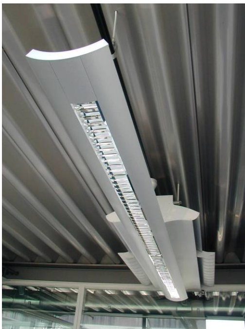
Obrázek 3.1 Nerezové profilované bednění a jednotky osvětlení, klimatizace a ventilace.
